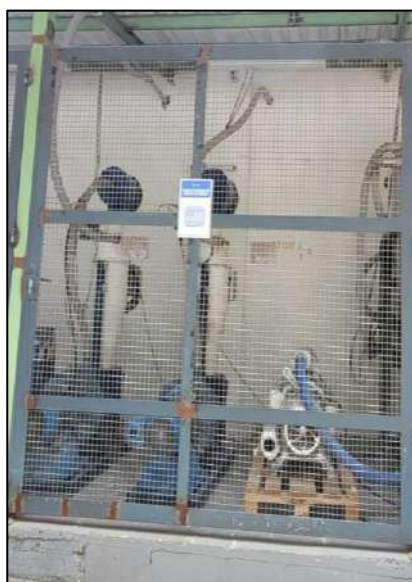
Figura 62 – Bombas de ar
