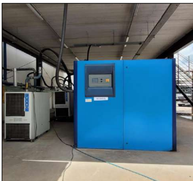
Figura 63 – Compressores de ar
