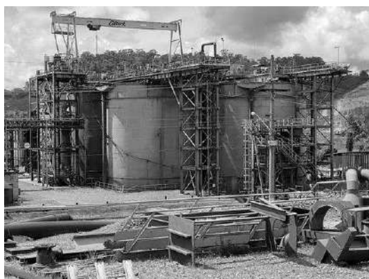
Figura 22 - Planta de processamento CIL
