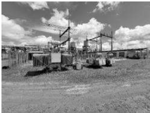
Figura 62 - Subestação elétrica principal (2)
