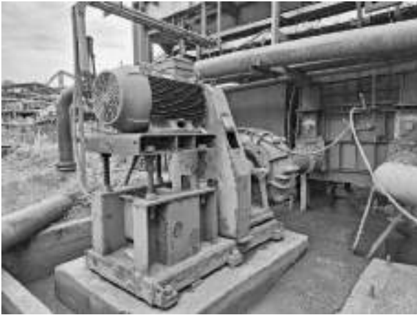
Figura 19 - Bombas Underflow Peneira Moagem
