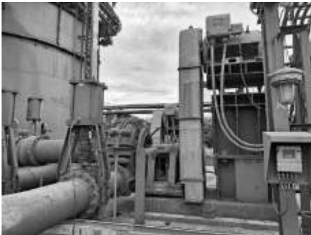
Figura 39 - Bomba Rejeito PU
