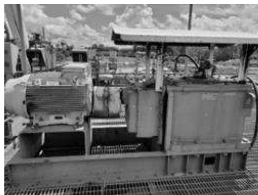
Figura 29 - Conjunto de agitadores para tanques detox
