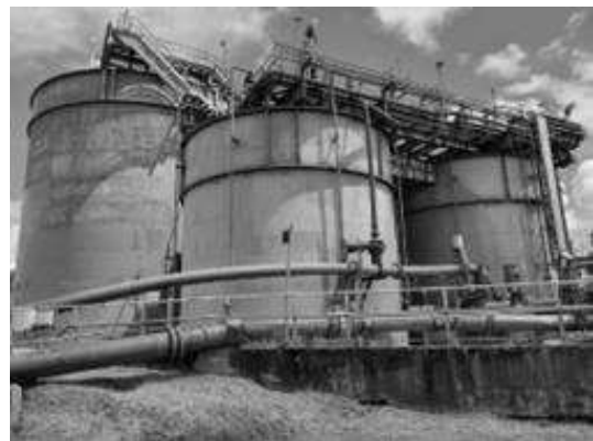
Figura 35 - Conjunto de dois tanques DETOX
