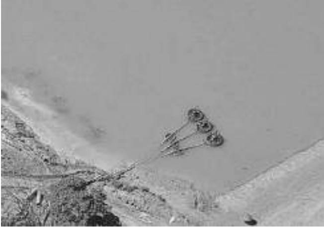
Figura 49 - Bombas Água Processo
