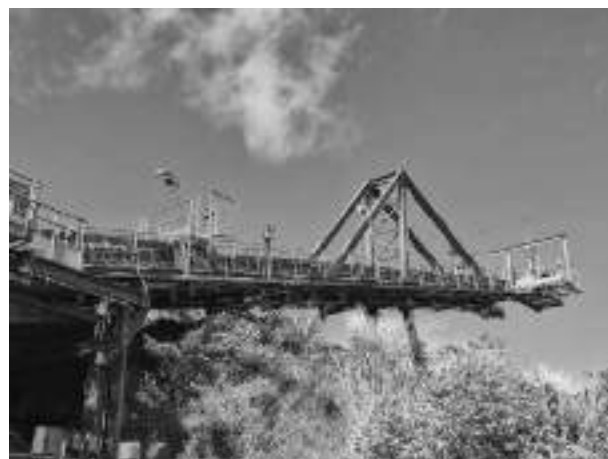
Figura 5 - Correia Transportadora CV-02
