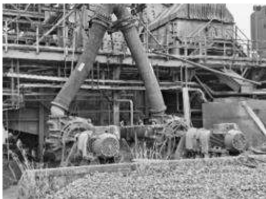
Figura 14 - Bombas de descarga para moagem WEIR MINERALS
