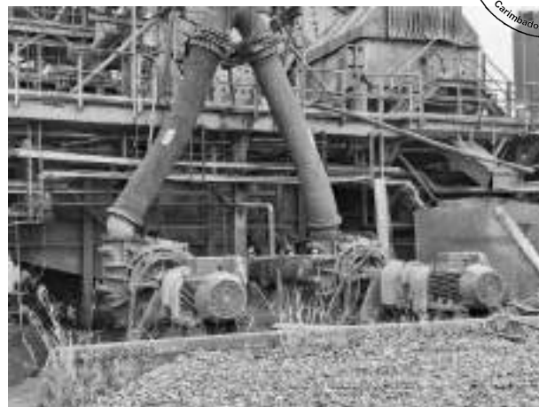
Figura 16 - Bombas de Descarga do Moinho
