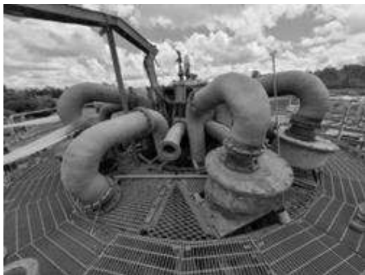
Figura 13 - Bateria de ciclones composta por 10 ciclones
