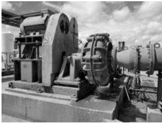
Figura 36 - Conjunto de 3 bombas WEIR MINERALS (1)
