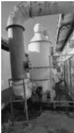
Figura 57 - Lavador de Gases
