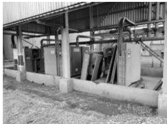
Figura 53 - Conjunto de Compressores de ar CHICAGO
