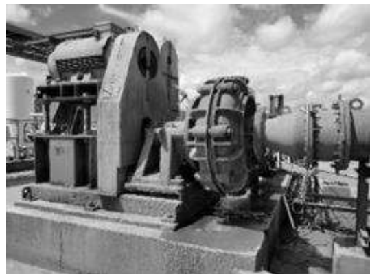
Figura 54 - Bombas de rejeito WEIR MINERALS
