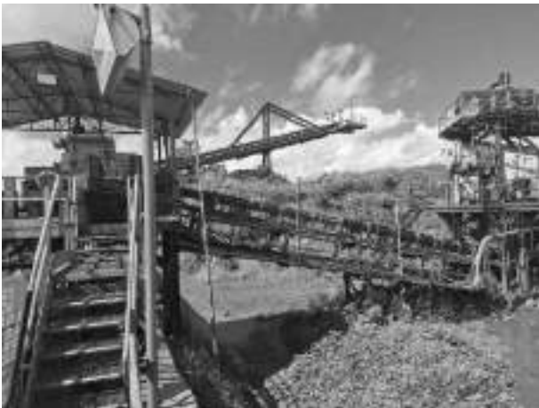
Figura 9 - Correia Transportadora CV-05
