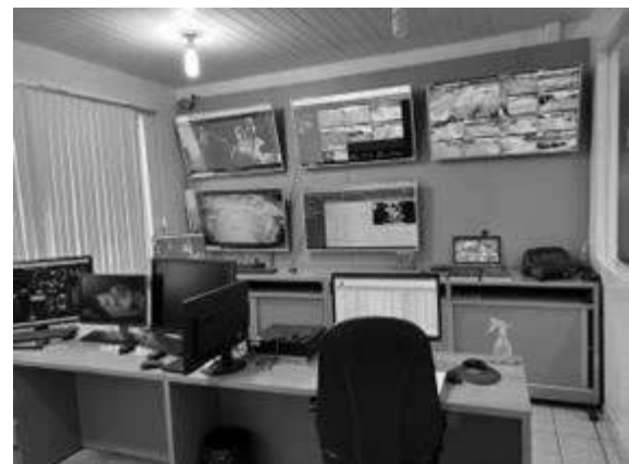
Figura 76 - Manutenção e sala de controle (2)
