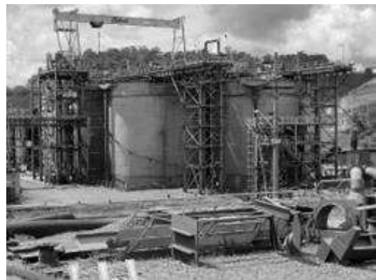
Figura 34 - Conjunto de 7 tanques em aço carbono CIL
