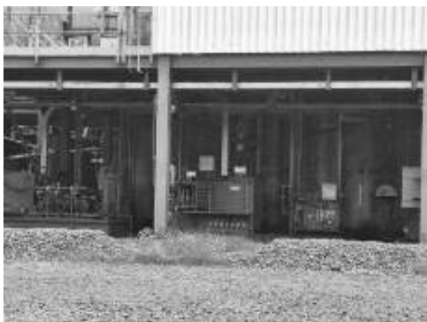
Figura 15 - Unidade Hidráulica Moinho Bolas
