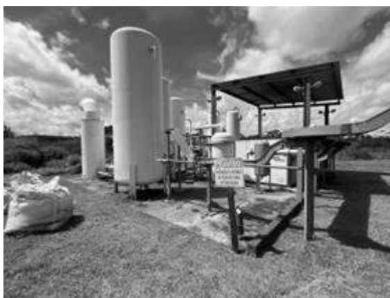
Figura 91 - Planta de oxigênio
