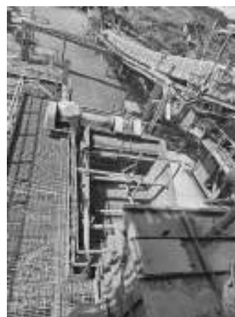
Figura 18 - Trash Screen – Moagem
